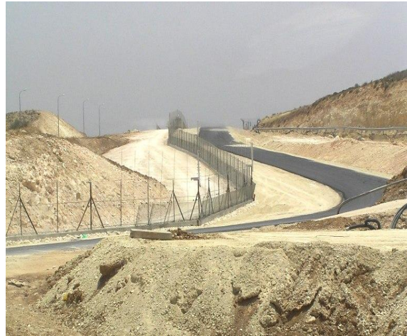
Figura 13 Parte de la valla de seguridad para la protección de la carretera de circunvalación de Beerseba a Hebrón, 2026. Fuente: Wikimedia Commons
